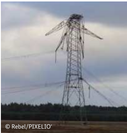
Sturmschaden durch den Orkan Kyrill im Jahr 2007
